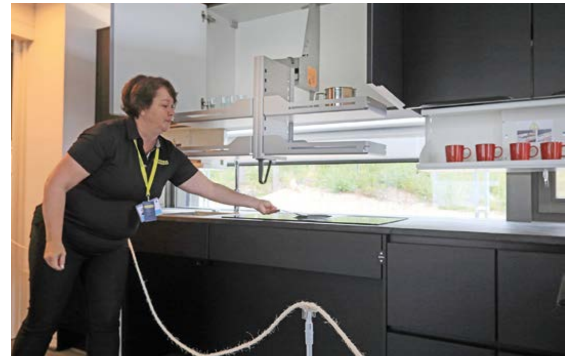
Villa Mikaelissa keittiön kaikki tasot ja kaapit liikkuvat sähköavusteisesti. Honka rakenteen edustaja näytti, kuinka keittiö oli suunniteltu ja toteutettu.
